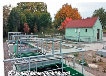
Obecní čistírna odpadních vod
